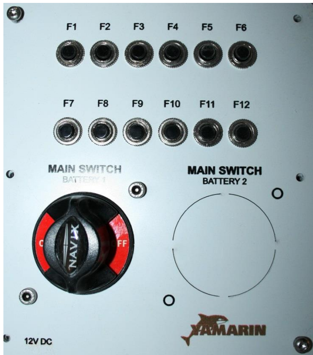
Kuva: Päävirtakytkin ja sulakkeet.
